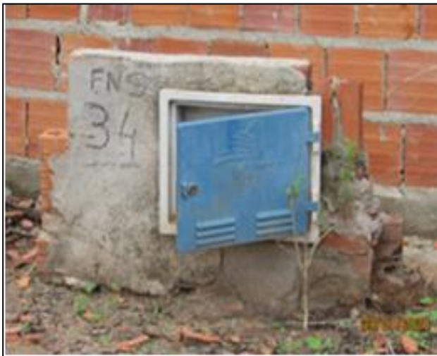
Foto 17 – Rede de distribuição d’água da CAGECE, que atende as áreas das localidades de Caiçara I, Caiçara II e Vazante.
