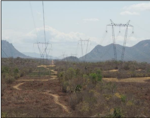
Foto 13 - Linhas de alta tensão da CHESF que interceptam a bacia hidráulica do futuro reservatório em seu trecho mais a montante (E-301.661; N-9.576.553).
